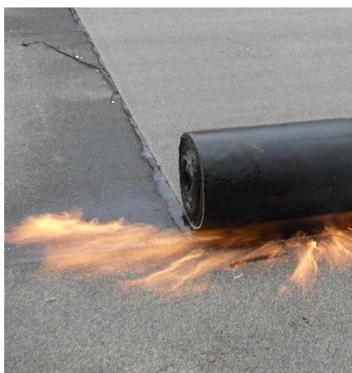
Рисунок 8 – Вытекание расплавленного битумного вяжущего из-под боковой кромки материала
